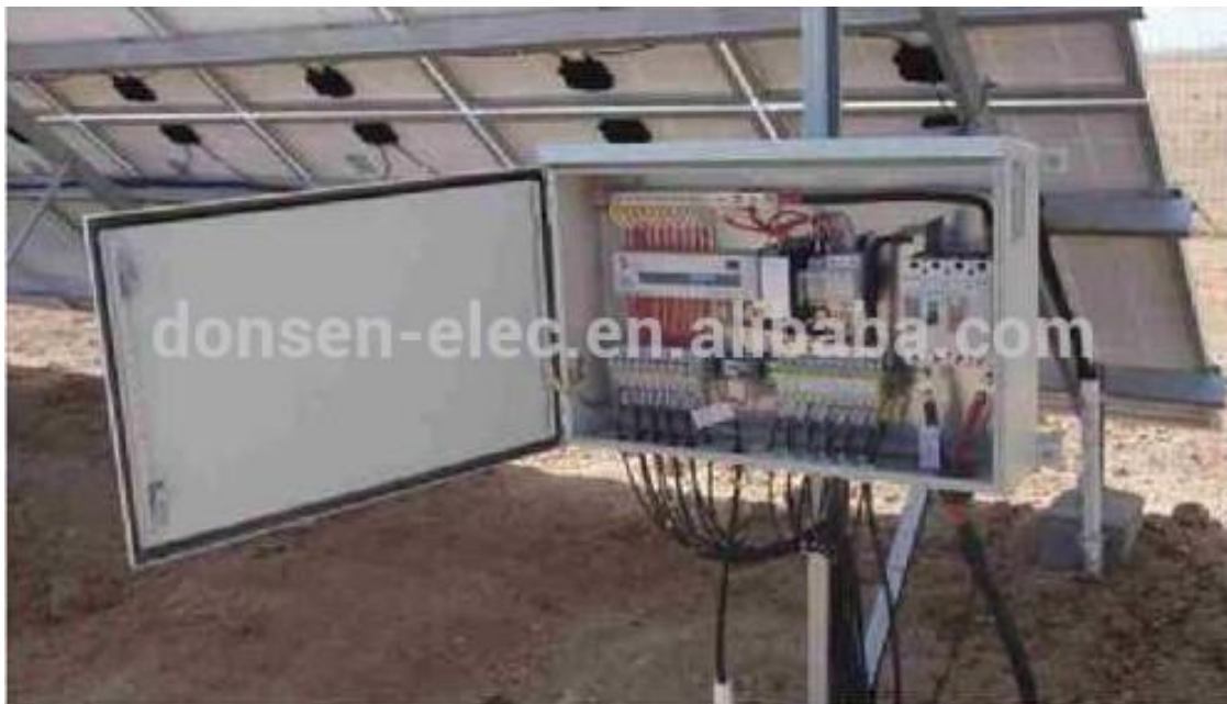
Slika 3. Primjer sabirnog ormara uz nosač metalne konstrukcije
